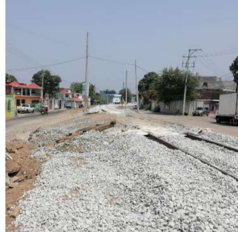
Temen que una vez concluida la obra, estos pasos queden así.
